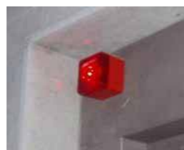
Luz exterior de montacoches ocupado
